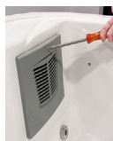
Dévissez la grille protectrice du skimmer
